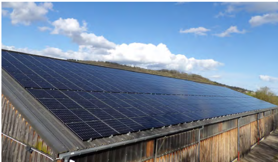
Centrale photovoltaïque sur le toit d'un hangar communal à Saint-Romain ©O'Sitoit
